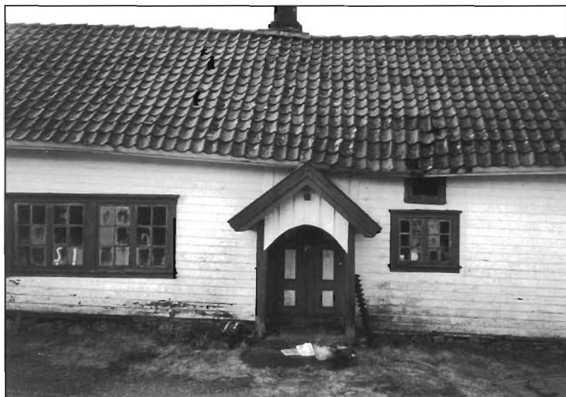
Slik så huset ut før restaureringsarbeidet startet. Vi ser at taket er nedseget. Heldigvis var årsaken til dette kun råteskade i takutstikket. Foto: Paul Tengesdal
