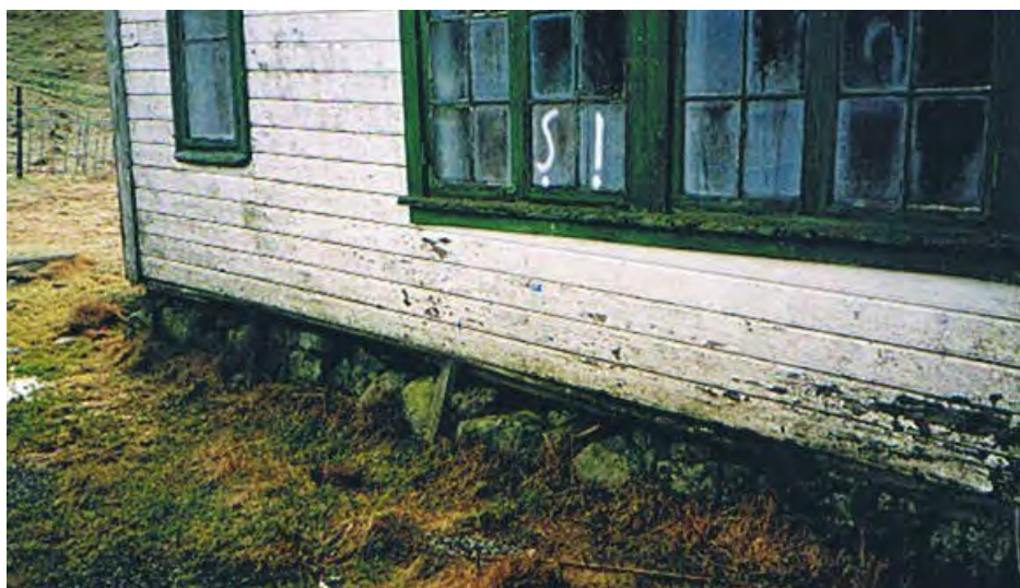
Kjellermuren på fremsiden. En del stein mangler.
