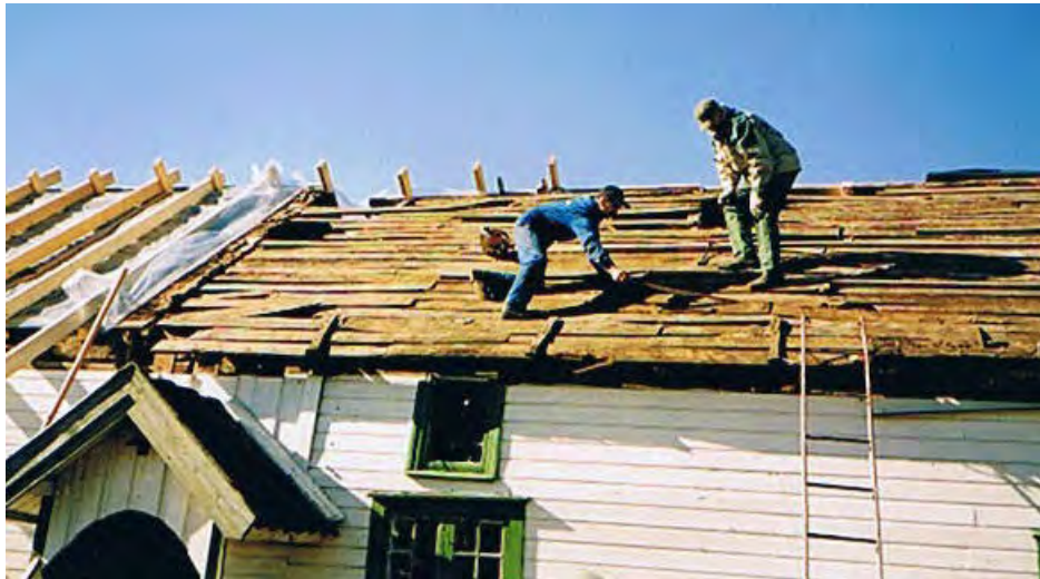
En del av taktribordene var råtne og måtte skiftes ut. Men alt som kunne benyttes ble anvendt, selv om det hadde noen råteskader. Dette bærer preg av elde, og er en del av byggets identitet.
