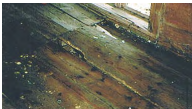
Noe av gulvet var råttent
